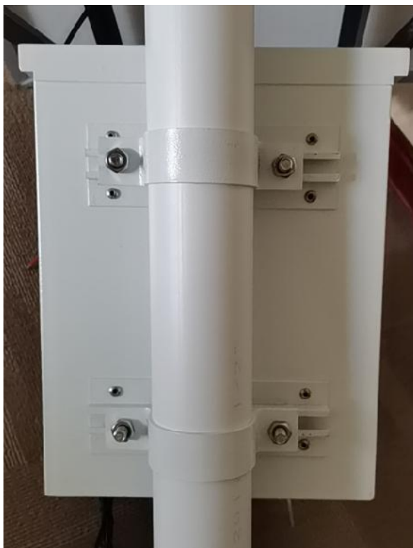
安装完成背面图
